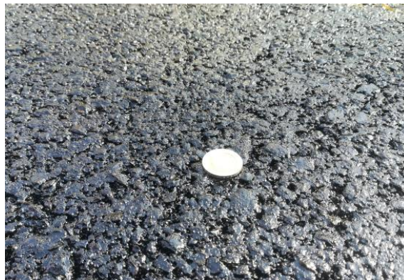
(Detalle de la textura y aspecto de la mezcla templada reciclada tipo AC16 surf S)
