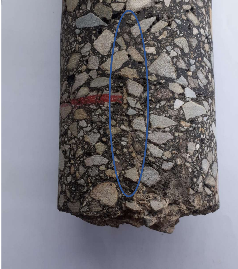
Foto 1: Imagen donde se observa el efecto de prevención de la propagación de fisuras
