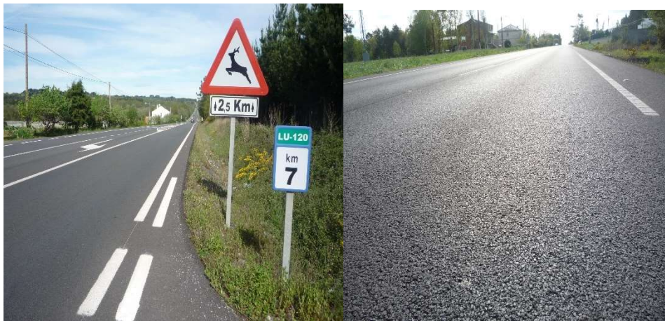
Foto 4: Aspecto del firme tras dos años de puesta en servicio.
