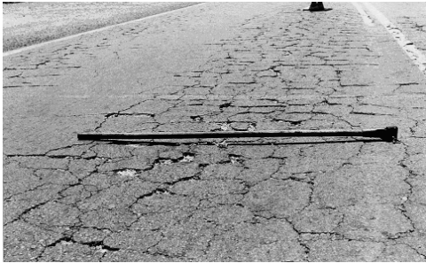
Deformaciones, blandones, agrietamiento, etc. NO APLICAR
